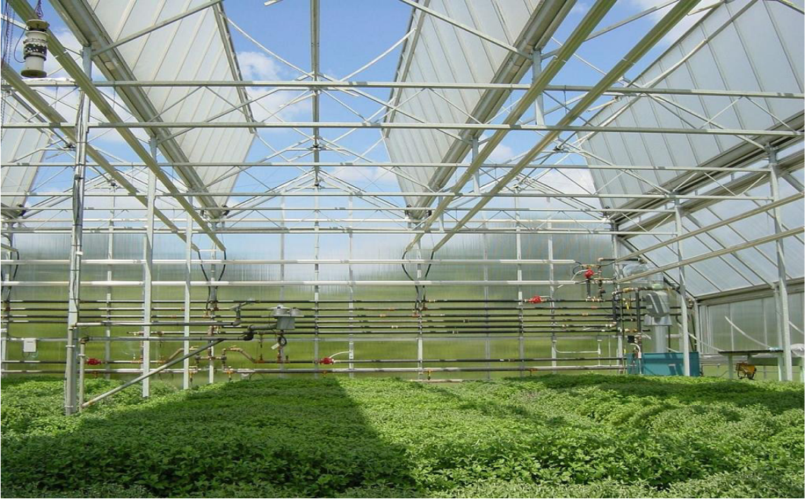
Kết cấu nhà kính cần bảo đảm nguyên tắc cứng, nặng, đủ độ bền vững để chống lại gió mạnh
